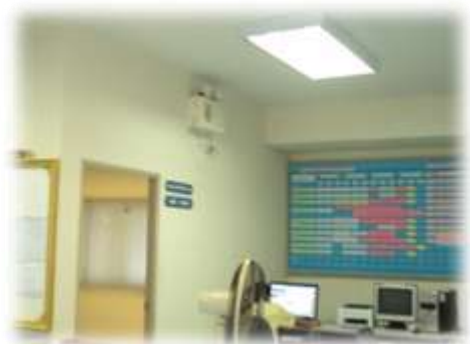
ไฟฉุกเฉิน
