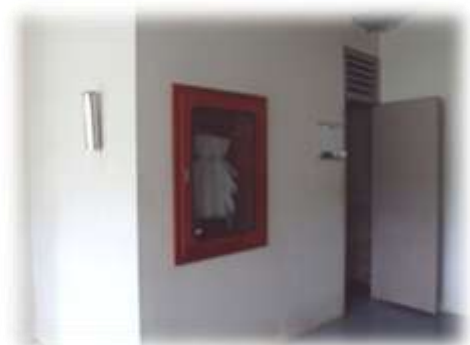
สายดับเพลิง
